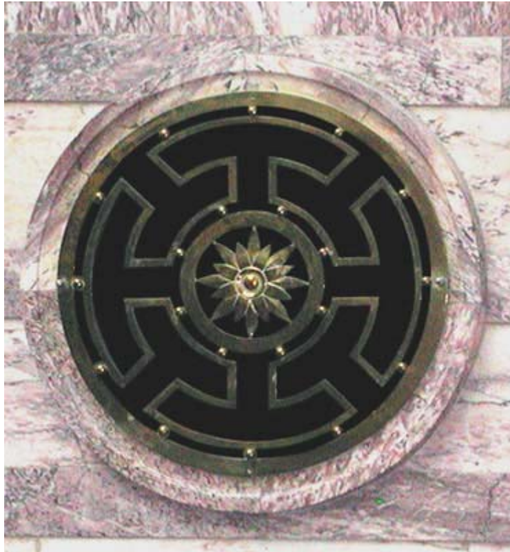
Αεραγωγός της εγκατάστασης εξαερισμού της Αίθουσας του Κοινοβουλίου Είσοδος προς το περιστύλιο και την Αίθουσα του Κοινοβουλίου
